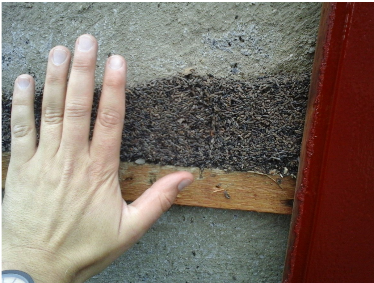
Vleermuisverblijf (keutels Gewone dwergvleermuis) achter bestaande gevelbetimmering met regelwerk. Pancerstraat Maastricht, Servatius (Bron: Arcadis)
